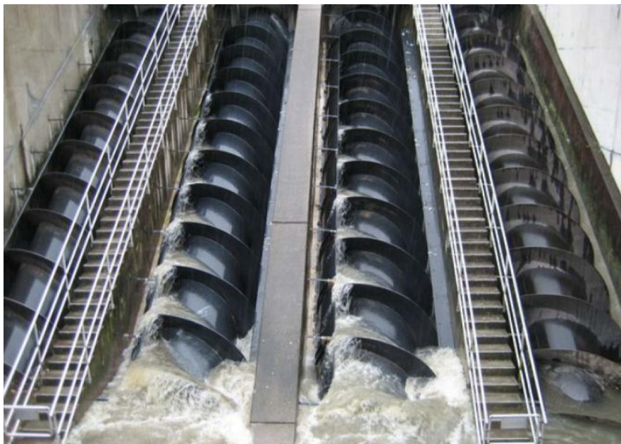
En pumpstation med fyra stycken Archimedesskrupumpar.
