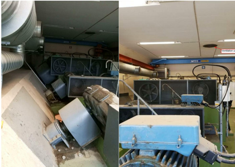
Bild 4. Pumpsalen vid Tullgarns pumpstation.
