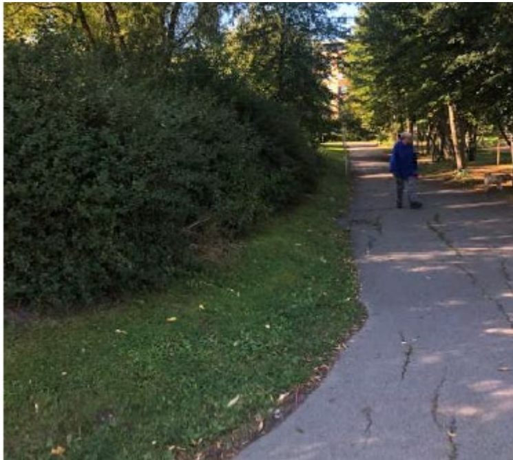
Figur 7. Sliten beläggning på delar av gång- och cykelvägarna runt skolan
