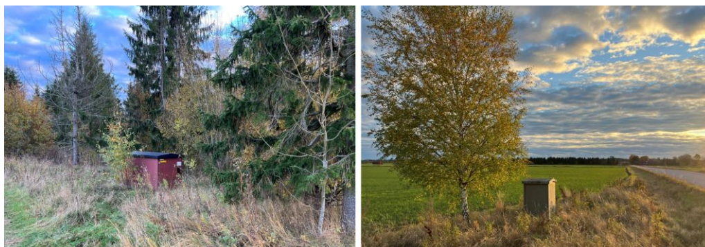
Figur 30 De två nätstationerna längs väg 630 som berörs av ett genomförande av detaljplanen.
