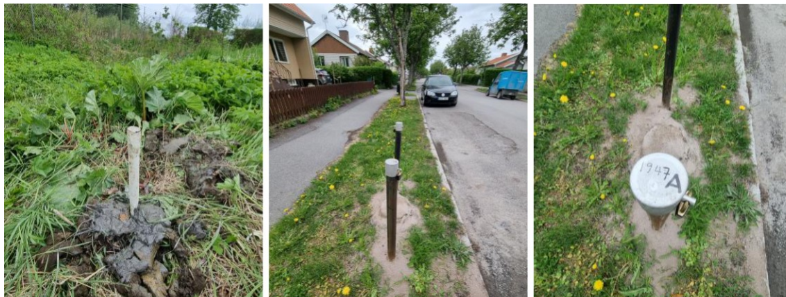
Bild 3.2.1 – 3.2.3: Vänster bild visar ininstallerat vattenrör i borrhål 3. Bilderna till höger visar befintliga rör 1947 A och B utmed Tunagatan. Det antas att dessa båda rör utgör grundvattenkontrollrör tillhörande Uppsala kommun.
