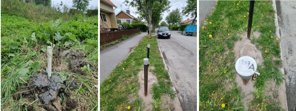
Bild 3.2.1 – 3.2.3: Vänster bild visar installerat vattenrör i borrhål 3. Bilderna till höger visar befintliga rör 1947 A och B utmed Tunagatan. Det antas att dessa båda rör utgör grundvattenkontrollrör tillhörande Uppsala kommun.
