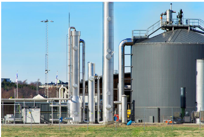
Biogasanläggningen vid Kungsängens gård
