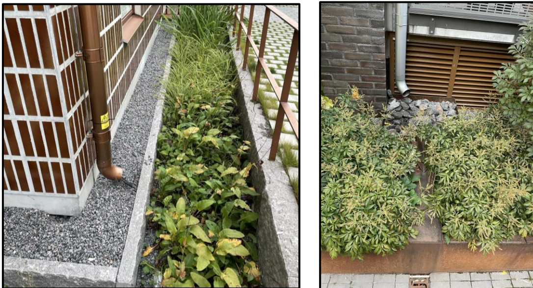
Figur 5-3. Exempelbilder för ledning av takvatten via stuprör till växtbäddar. Foton Structor Mark Uppsala.
