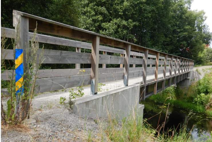
Figur 7. Exempel: gång- och cykelbro över Lillsjöns utlopp i Svennevad (bild från BaTMan).
