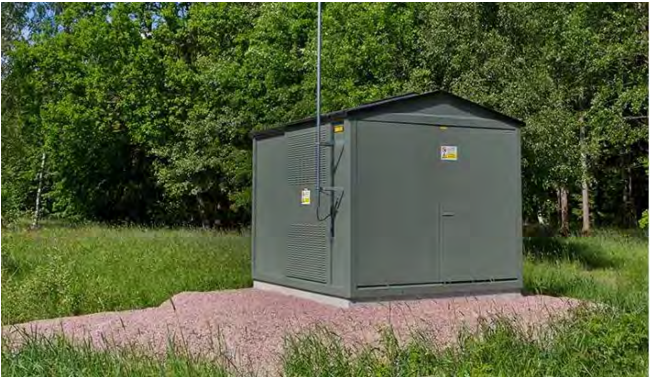
Figur 18-Exempel på mindre transformatorställverk som placeras ut i parken.
