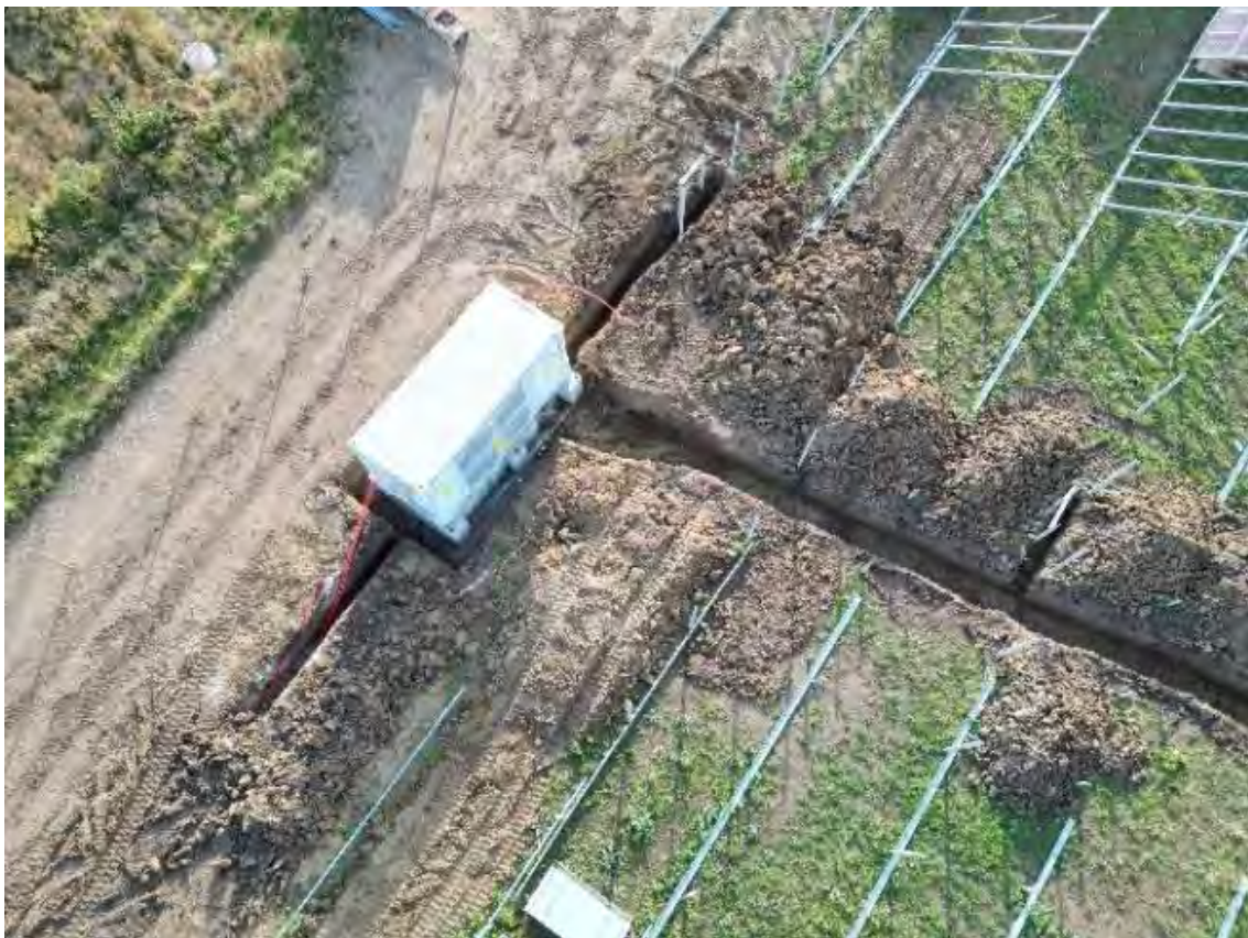
Figur 20-Exempel på ställverksbyggnad med betongfundament.
