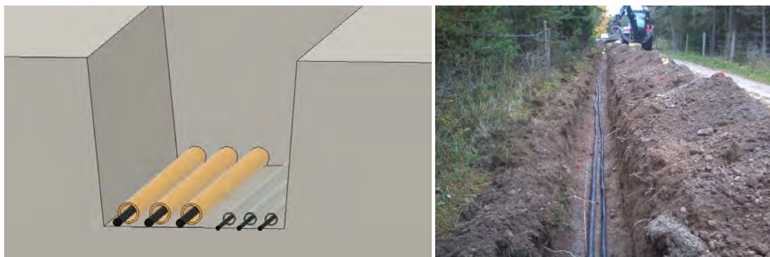
Figur 21-Vänster: Skiss av kabeldike med exempel på kanalisation för lågspänningskablar och kommunikationskablar. Höger: exempel på grävt kabeldike (foto: Albers maskinstation) invid väg.
