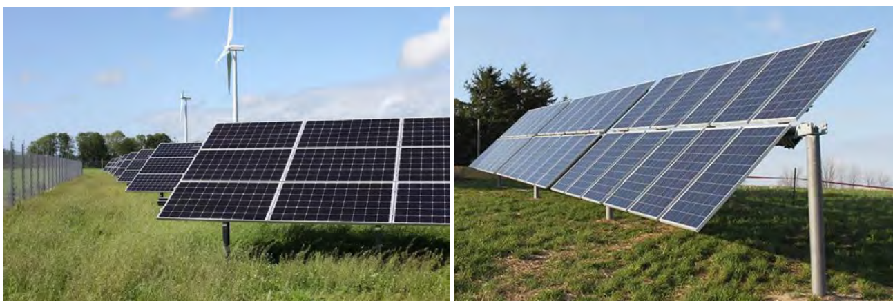
Figur 13-Vänster: Exempel på kisel-solcellsmoduler med aluminiumram på markställning. Bilden visar Varberg Energis park Solsidan i Tvååker. Höger: Exempel på solcellsmoduler på enaxliga solföljare.
