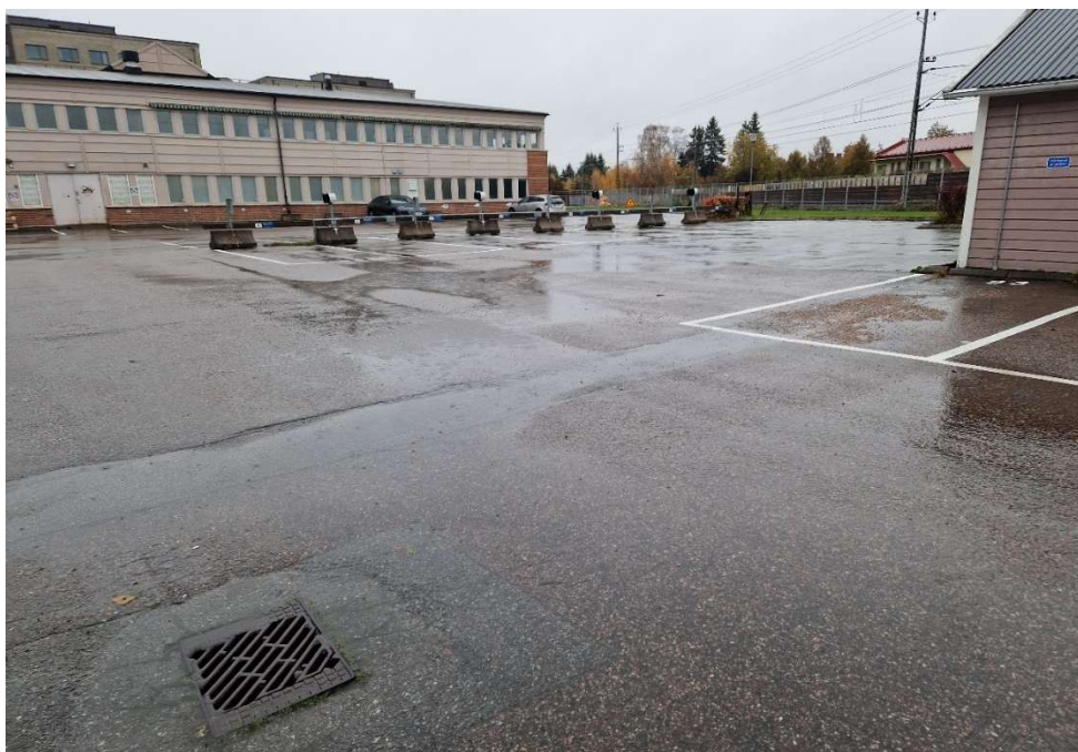
Figur 16. Dagvattenbrunn och yttlig avvattningsyta av den större parkerings- och körytan belägen mellan befintlig fastighet och järnvägen. Servicehuset, till höger i bild, avvattnas via stuprör.
