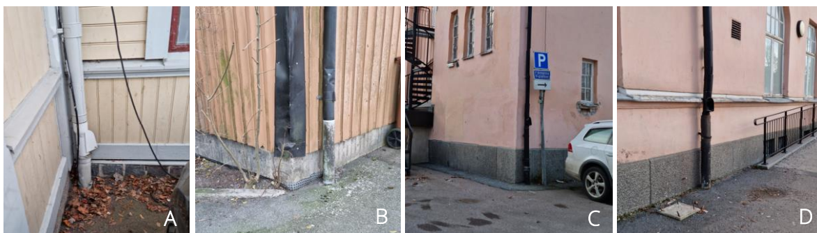
Figur 2. Urval av bilder på stuprör med anslutning till uppsamlingsledning under mark. Bild A från Flustret, bild B från Svandammshallarna och bild C och D från Svettis.
