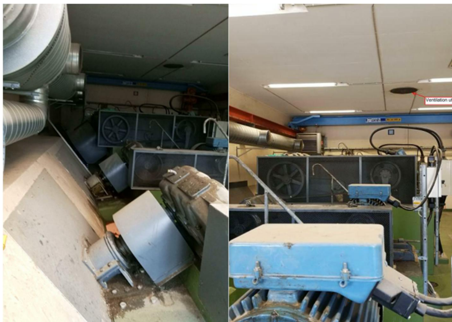
Bild 4. Pumpsalen vid Tullgarns pumpstation.
