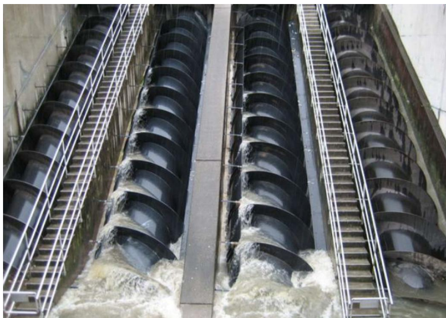
En pumpstation med fyra stycken Archimedesskruvpumpar.
