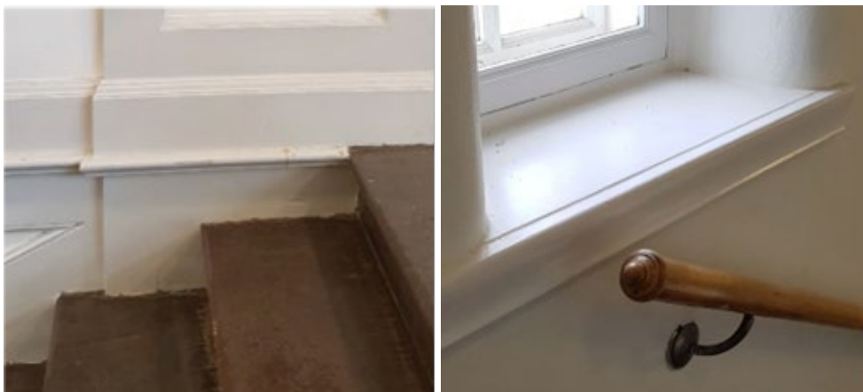
Bild 8 och Bild 9 - Bilden till vänster visar detalj på trappa och profilerad vägg i huvudtrapphuset. Bilden till höger visar räckesdetalj och fönsternisch i sekundärtrapphuset. White.
