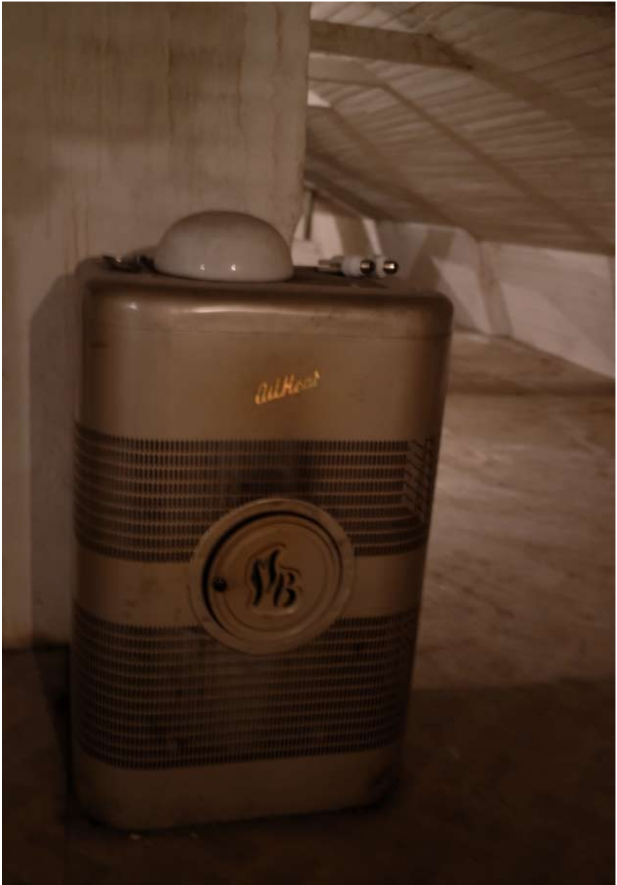
Torkaggregat på vinden. En del av vindsutrymmet har en tid använts som torkrum för de boende i fastigheten
