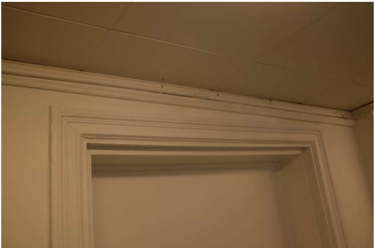
Detalj av igensatt dörrhåll. Notera att det senare undertaket p.g.a. sättningarna inet är parallellt med dörrhålets överstycke.
