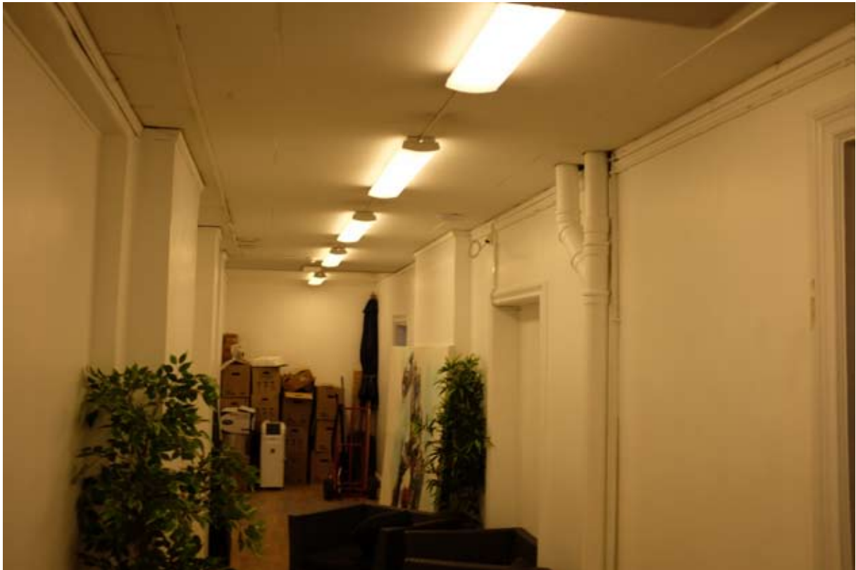
Korridor på plan 1 med sekundärt undertak och avloppsledningar.
