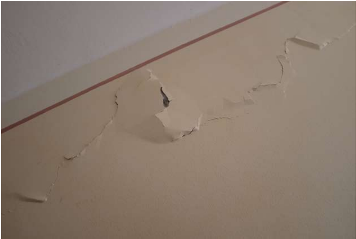
Detalj av sättningsspricka i trapphuset. Röreslerna i tegelmurverket har fått väggens puts och färgskikt att spricka.
