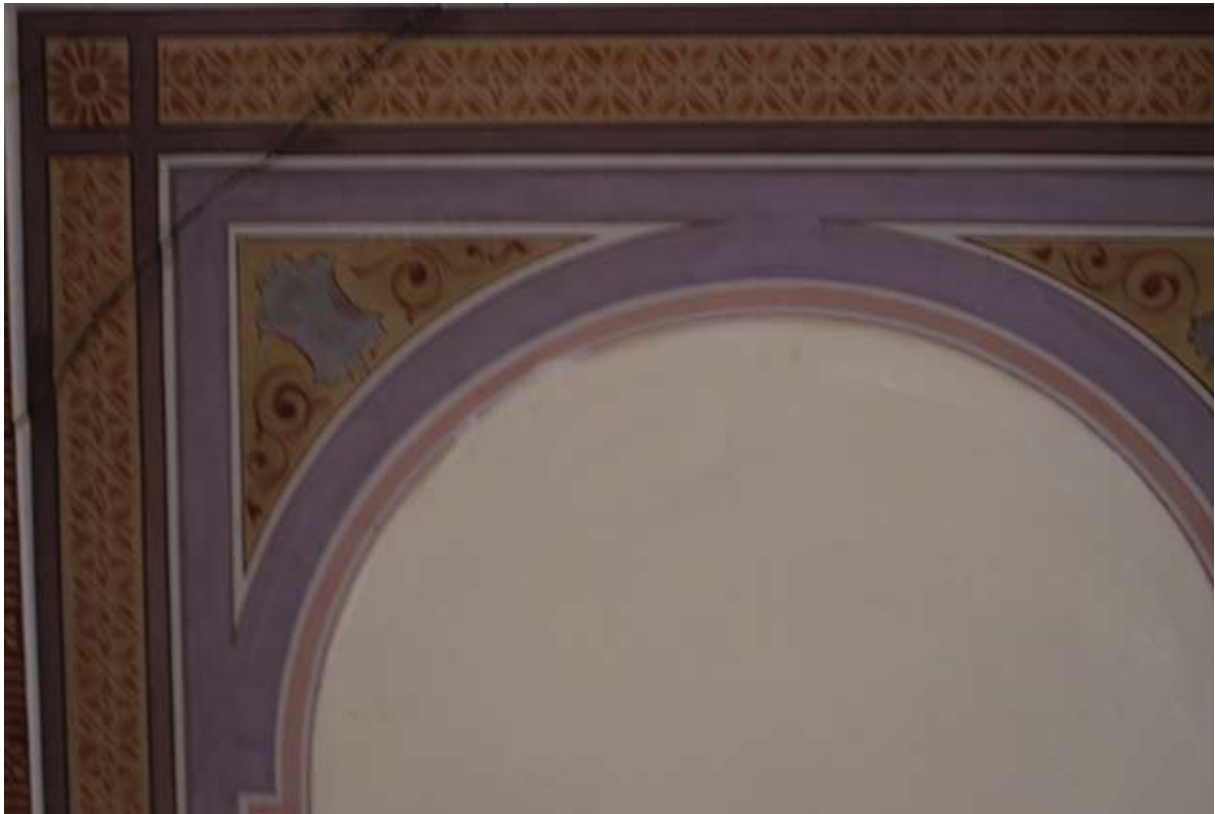
Detalj av dekormålning i trapphuset. Notera sättningsprickan i vänstra övre hörnet.
