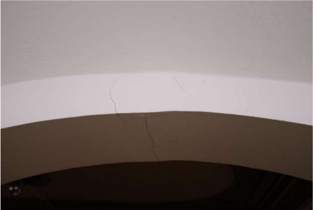
Sättningskada i valv i trapphuset. Valvets deformation avslöjar att den vänstra sidan av valvet satt sig. Murfogarna har spruckit, och tegelstenarna hålls på plats av trycket från omgivande murstenar.
