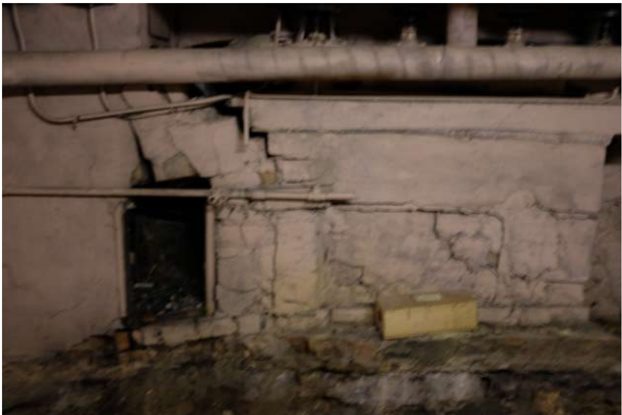
Detalj av sättningsskada i källaren. Murstocken till vänster har satt sig betydligt i förhållande till omgivande grundmurar. Sättningsproblem är vanligt förekommande i äldre stenhus på Uppsalaslätten. De oerhört djupa lerlagren kräver särskild grundläggning för att inte sättningarna ska utvecklas med tiden.
