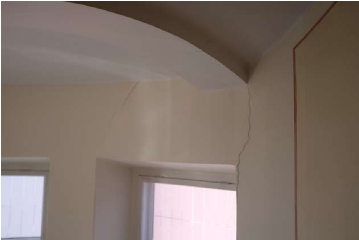
Sättningsprickor vid fönster i trapphuset. Fönsteröppningar är särskilt utsatta. Den högra sidan har satt sig i förhållande till den vänstra.
