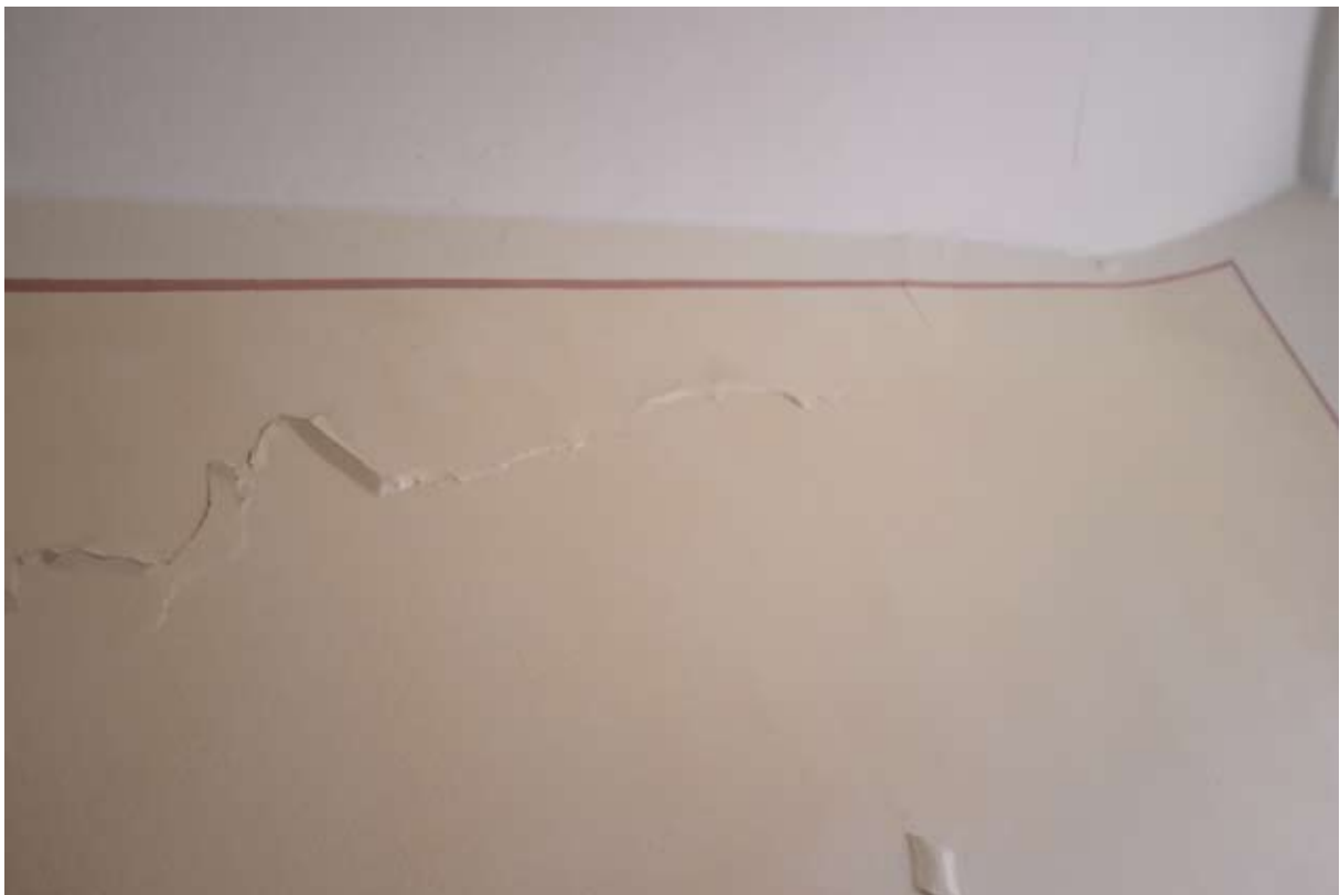
Sättningsspricka i trapphuset. Notera hur sprickan fortsätter även upp i taket.
