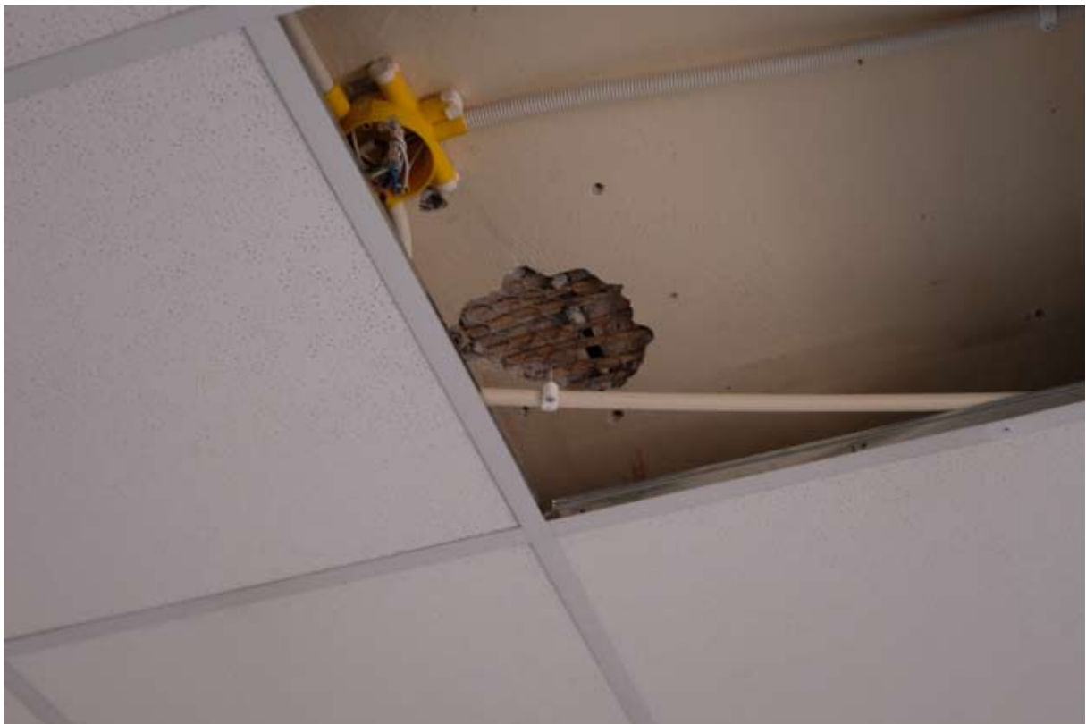
Detalj av undertak på plan 1. Under det nedpendlade akustiktaket syns ett putsat undertak. Skadan där eldragningen fästs i taket visar att putsen är applicerad på hönsnät med vassrör. En vanlig teknik under decennierna runt sekelskiftet 1900.
