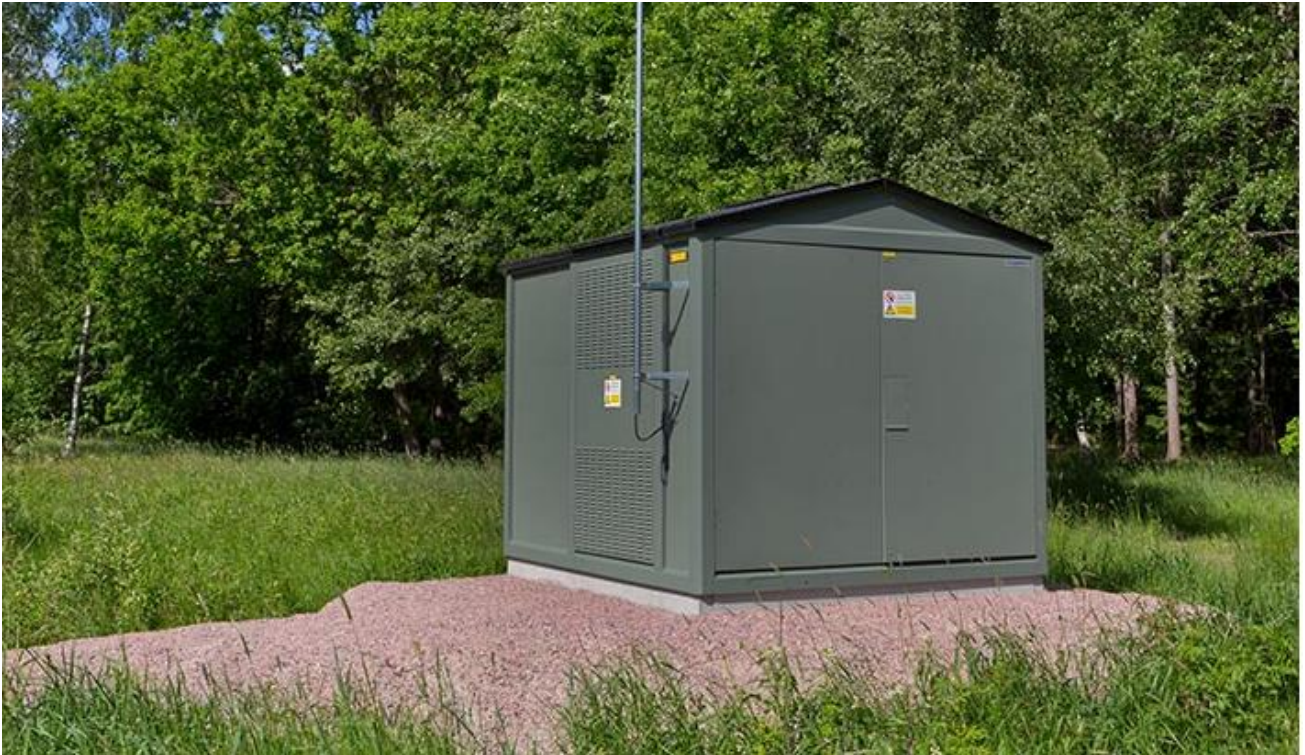
Figur 11-Exempel på mindre transformatorställverk som placeras ut i parken.
