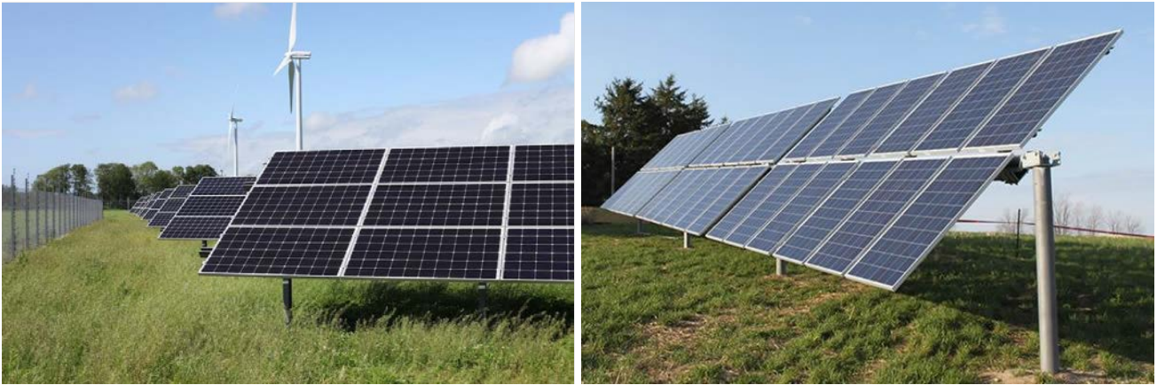
Figur 8-Vänster: Exempel på kiselcellsmo­duler med aluminiumram på markställning. Bilden visar Varberg Energis park Solsidan i Tvååker. Höger: Exempel på solcellsmo­duler på enaxliga solföljare.
