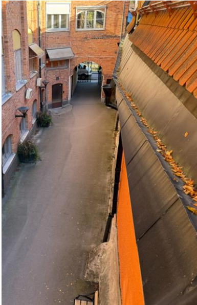
Figur 10. Befintligt sadeltak som via stuprör går ned i marken i gränden i nordväst.
