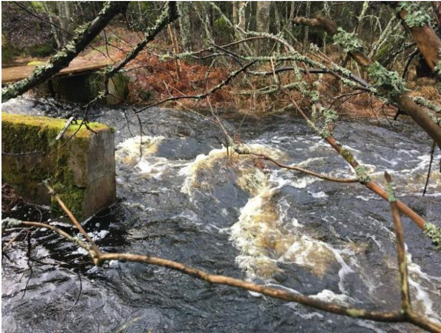
Figur 27. Norrängsbäcksdammens kvarvarande fundament i betong, där själva dämnet är utrivet. Bild från högflödesepisod 15 december 2019. Dämnet fungerade då som en "flaskhals" och fördröjde flödet så pass att det troligen räddade Dalådämnet i Harvikadammen nedströms från skador. Foto: Bernt Östergren.
