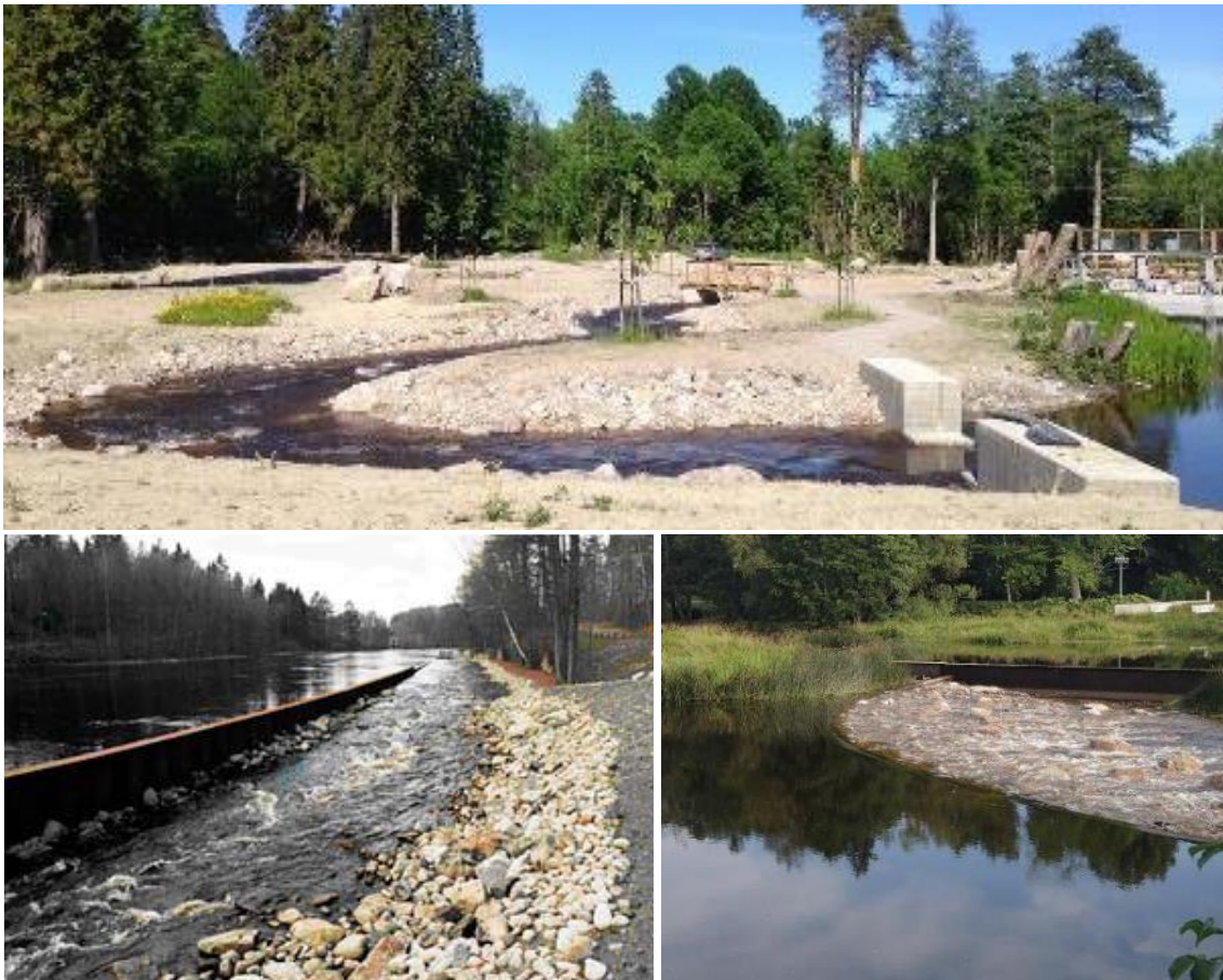
Figur 45. Ovan: Omlöp i Storådammen Tämnaån, Jönköping (Länsstyrelserna m.fl., 2016). Nedan t.v.: Inlöp vid Hemsjö övre som avgränsas med stålspons mot Mörrumsån (Naturvårdsverket och Fiskeriverket, 2008). Nedan t.h.: Ett överlöp i Spegeldammen Nedre Gavleån, Gävle (Länsstyrelserna m.fl., 2016).
