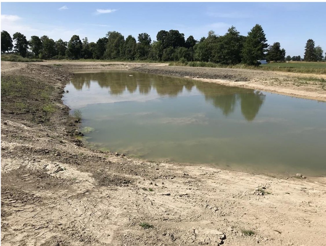
Figur 23. Golvasta fosfordamm vid slutbesiktning 22-07-26. Källa: (WEREC, 2021a).
