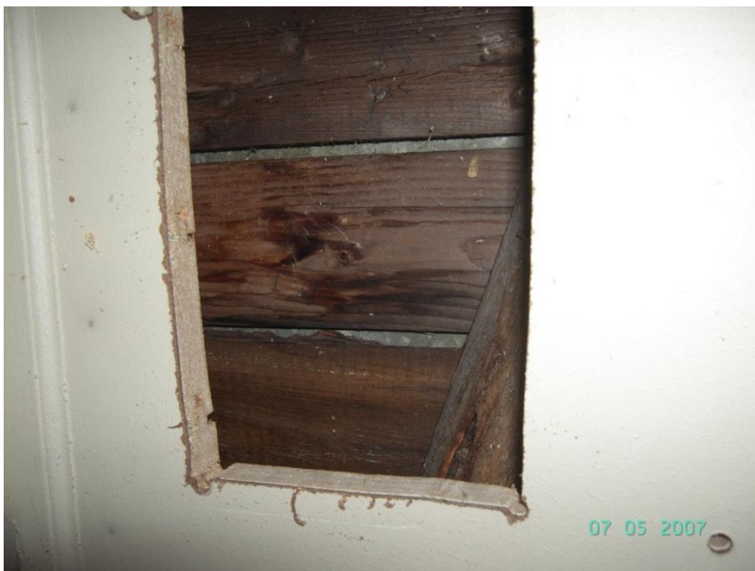
Bild 3: Sluttande tak på övervåningen utan isolering, i Vaksala kyrkskolas lokaler.
