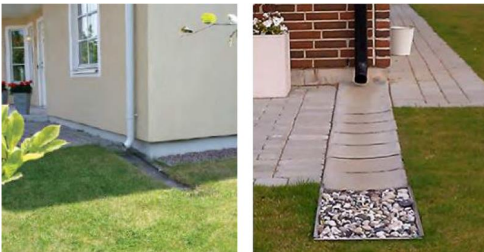
Figur 15. Rinnplattor kan användas för att leda bort regnvatten från stuprör till gräsmatta. Källa: NSVA.
