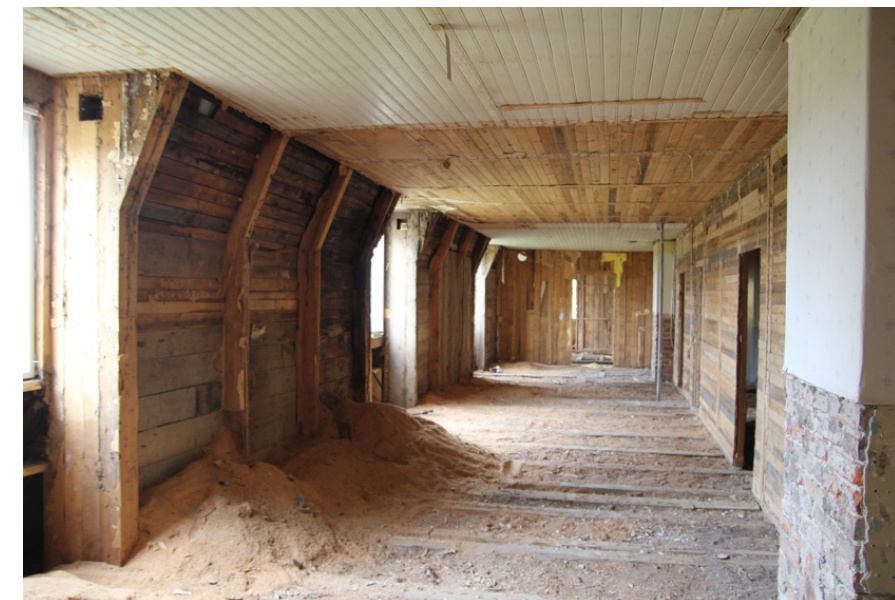
F.d. korridor och lärosal, vån 1 tr. Foto av insidan på nordöstra långsidan efter att delar av plankstommen och golvbjälklaget frilagts. Dubbla plankväggar med mellanliggande isolering av sågspån som ligger i en hög på golvet sedan den inre plankväggen demonterats. Väggreglarna är sammanfogade med takstolarna.
