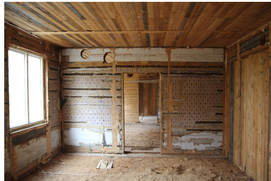
F.d. matsal, vån. 1 tr. Bilden visar frilagda liggtimmerstockar i den ursprungliga byggnadsdelen från 1872. Tidstypiska tapeter från 1870-talet med blått tryck. Spår av ljusgrå väggbröstning.
