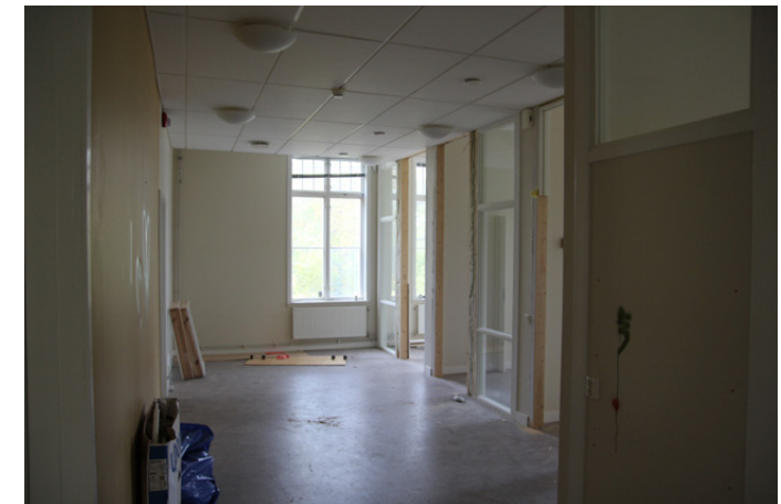
Södra delen av bottenvåningen inreddes med nya kontorsceller för församlingsexpeditionen efter ritningar från 2004. Nytt undertak med akustikplattor från samma tid.
