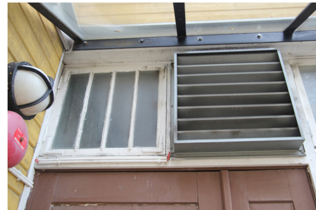
Friskluftsintag till fläktaggregat bredvid fönsterbåge som är den enda äldre fönsterbåge som finns kvar i huset.
