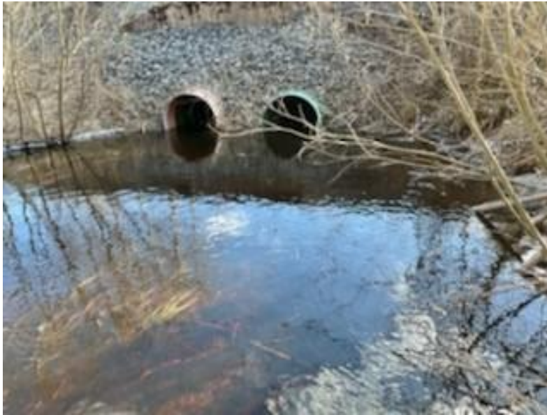
Figur 2-8. Bild på dagvattentrummor under banvallen från platsbesök. Källa: Walloxstrand AB.
