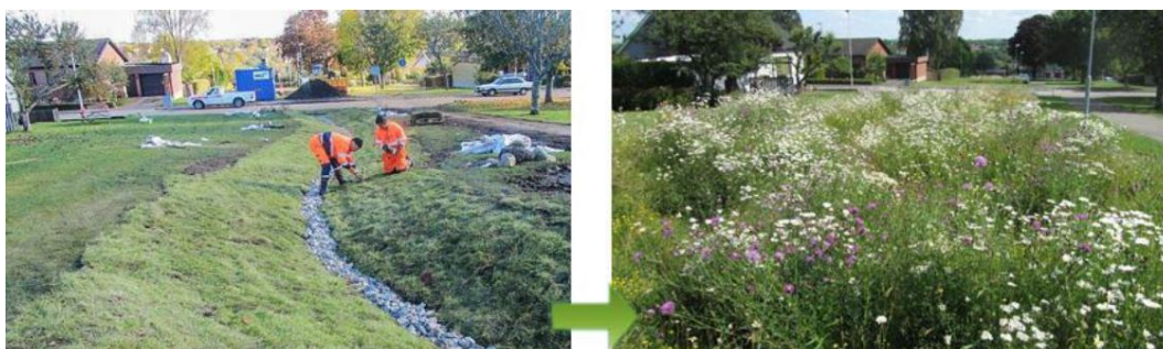
Figur 13. Exempel på ett mindre svackdike som utformas med växtlighet. Figuren är hämtad från VegTech.
