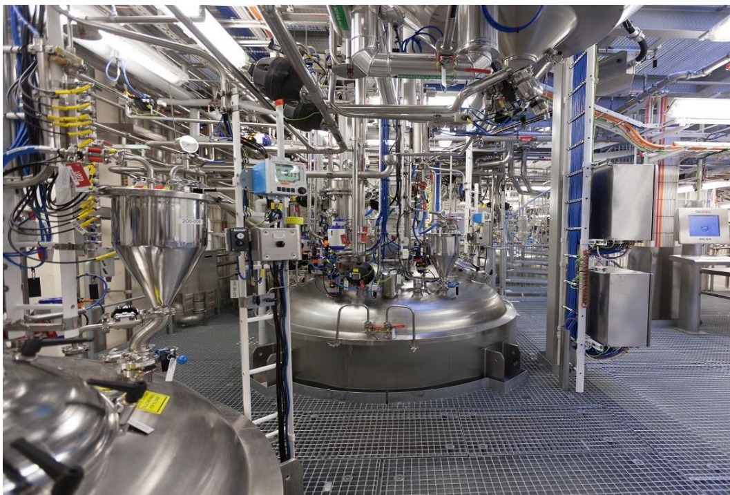
Figur 6 Exempelbild från produktion med flertal kärl av olika slag och div rör och installationer.
