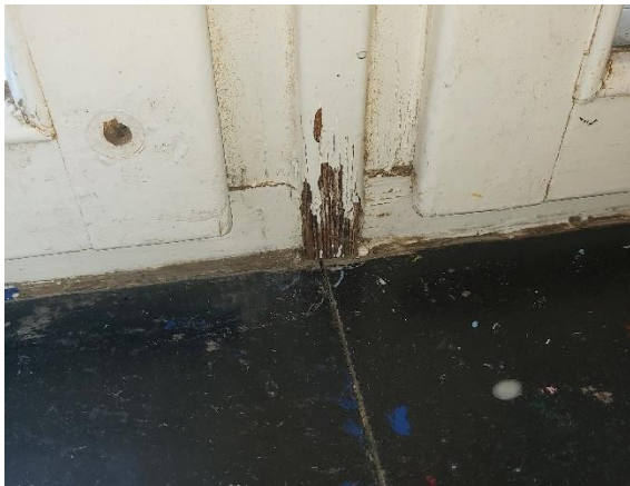
Foto 13 färgsläpp nederkant fönsterlist
