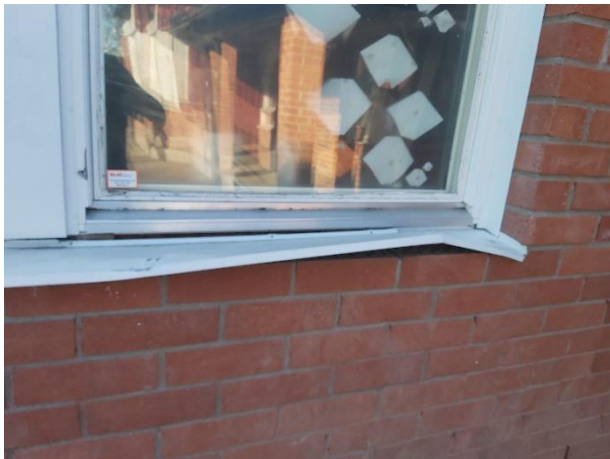
Foto 1 plåt skadad samt lossnat från fönster
