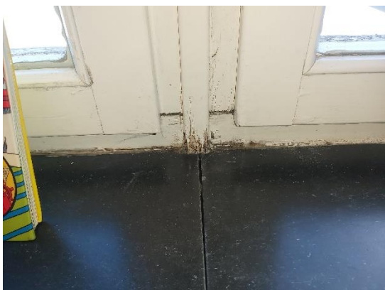
Foto 21 färgsläpp nederkant fönsterlist
