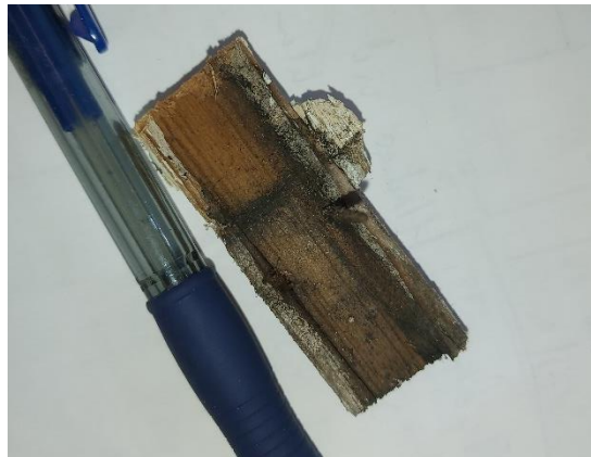
Foto 18 kraftiga missfärgningar baksida fönsterlist
