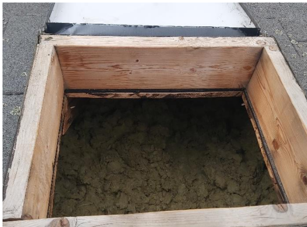
Foto 5 lucka till tak i C1
