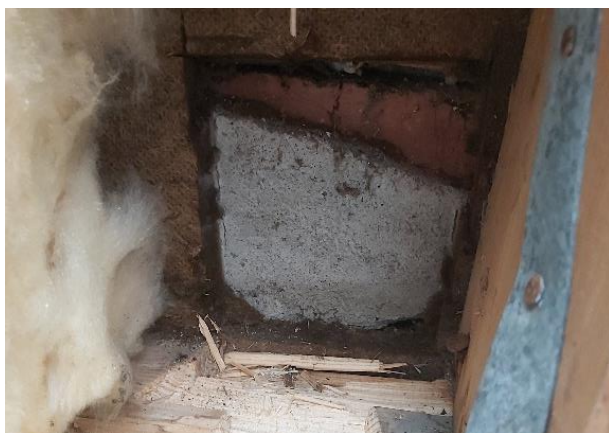
Foto 9 murtuggor nederkant vägg bakom asfaboard i YV3
