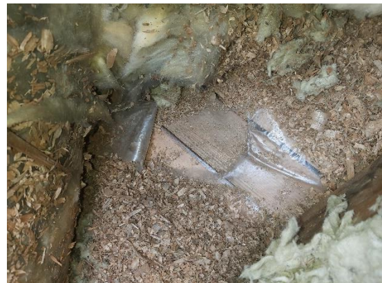
Foto 4 plast uttjänt samt sågspån under isolering
