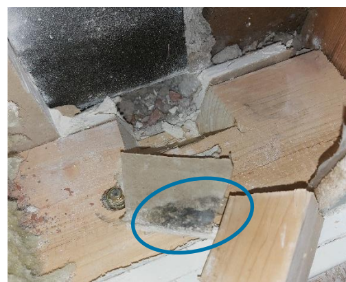
Foto 14 synliga mögeskador nederkant GU skiva YV23. "Öppen" skarv mellan nyare GU skiva och asfaboard
