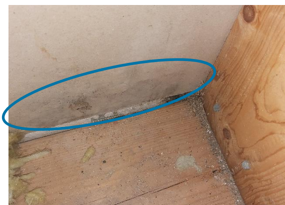
Foto 13 Synliga mögelskador på insida GU skiva i YV21
