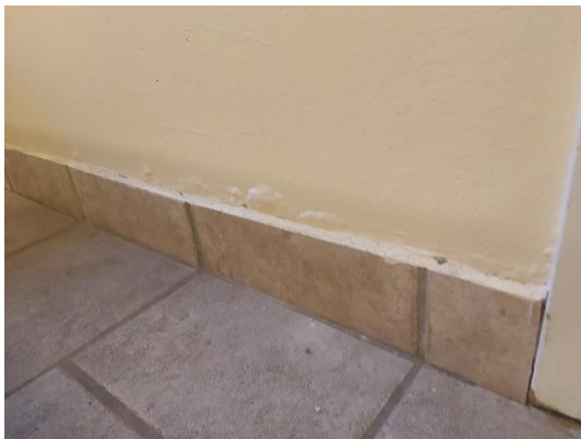
Foto 1 putssläpp nederkant betongväggar
