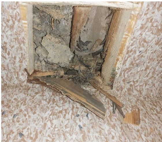
Foto 9 synliga röt-/mikrobiella skador på trämaterial
