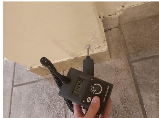
Foto 2 kraftigt förhöjda skalutslag vid fuktindikering mot nederkant pelare vid putssläpp
