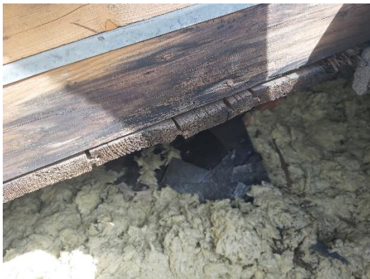
Foto 3 fuktskador på takstol/råspont vid lucka
