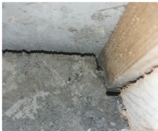
Foto 8 stående träläkt går ned under betonggolvnivå. Glipa kan innebära att luft kan sippra upp med lukter samt ev. radonhaltig luft.
