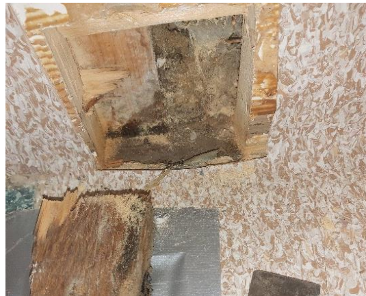
Foto 6 synliga fuktskador i utreglad vägg
