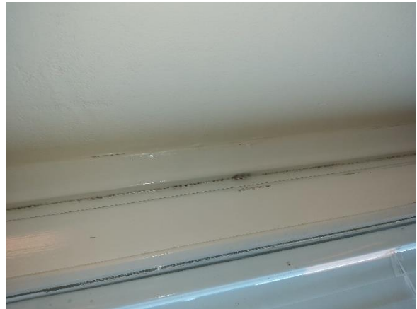
Foto 14 smuts/partiklar pga. luftläckage vid fönster/vägg
