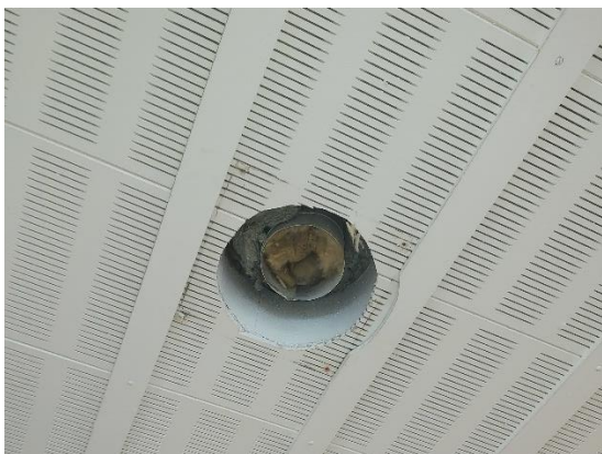
Foto 23 ventilationsgenomföring i tak. Täckplåt demonterad
