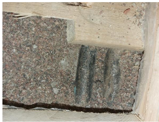
Foto 20 närbild på sand, träläkt samt vattenrör
