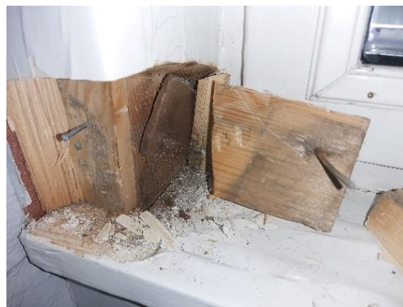
Foto 10 synliga mögelskador vid fönster YV7
