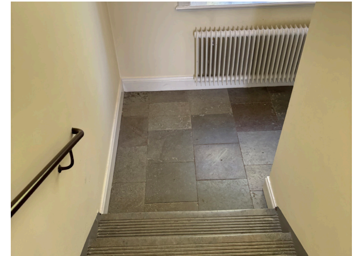
Trappa och golv av kalksten, äldre golvlister och smidesräcken är viktiga karaktärs- och värdebärande detaljer. Även äldre element är viktiga och bör så långt som möjligt bevaras.
