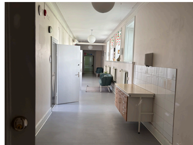
Generellt är golven belagda med moderna plastmattor i nästan alla utrymmen på våningsplanen ovan jord. Plast-mattorna har inget värde i sig men kan dölja ursprungligt golvmaterial.
