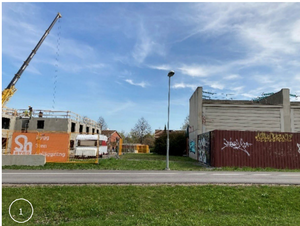
Figur 6, nytt bostadshus till vänster i bild och befintlig transformatorstation till höger i bild.
