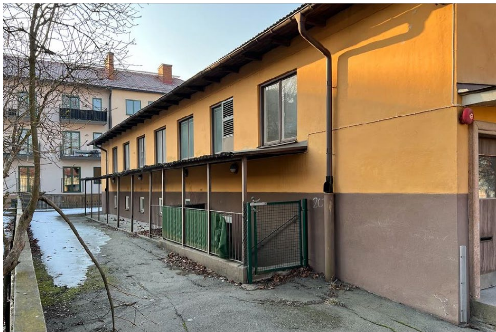
Figur 12 visar skärmtak på bakomliggande fasaden och trappa som leder till källarvåningen. Del av skärmtaket trappan och två fönster och en dörr behöver rivas för att möjliggöra en hiss.
