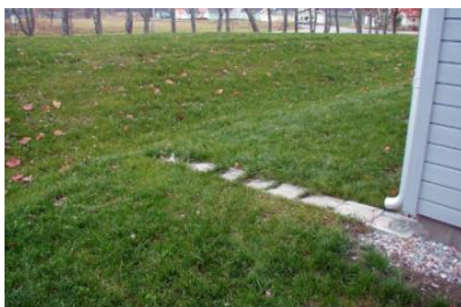
Figur 10. Erosionsskyddat utlopp från stuprör (Stockholm vatten och avfall, 2017).
