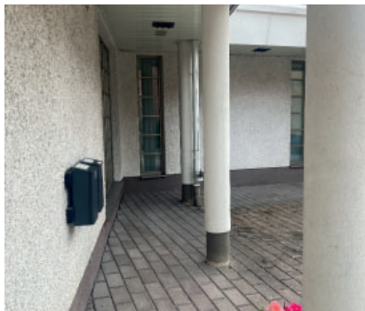
Betongsockel med frilagd ballast.
